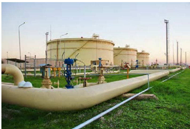
شکل ۲۱- نمایی از خطوط انتقال سوخت
